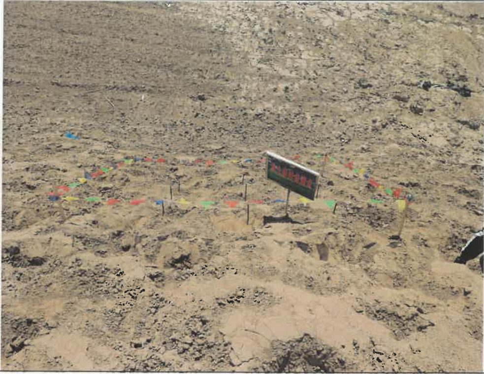
道路边坡监测点
