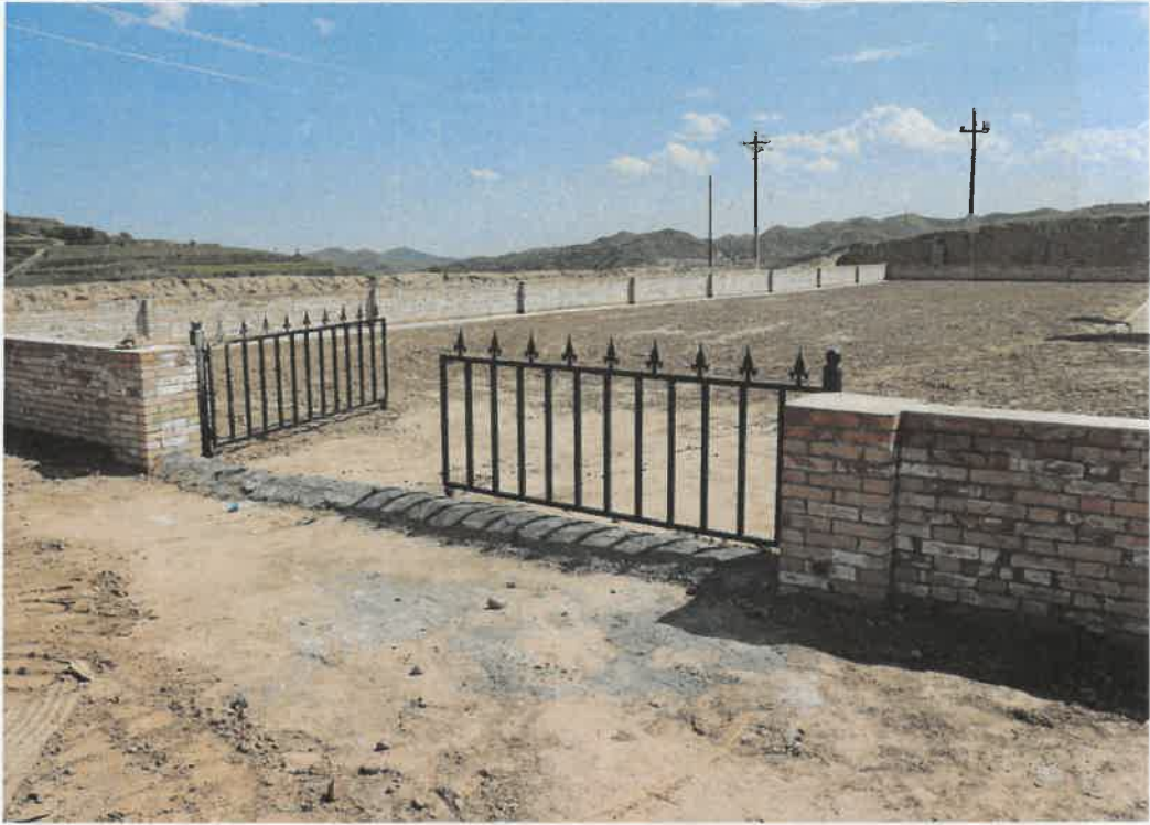
井场入口处拦水埂
