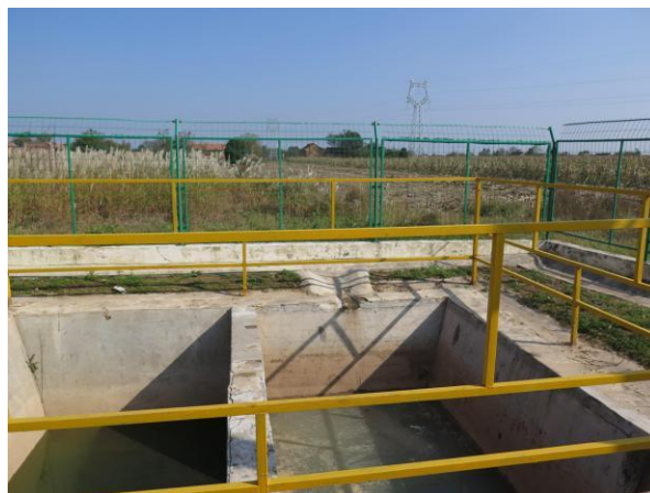
排水沟、集雨池、污水池 (JH2P8 井场)
