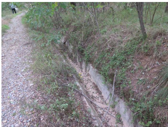
道路排水沟 (17P32 井场)
