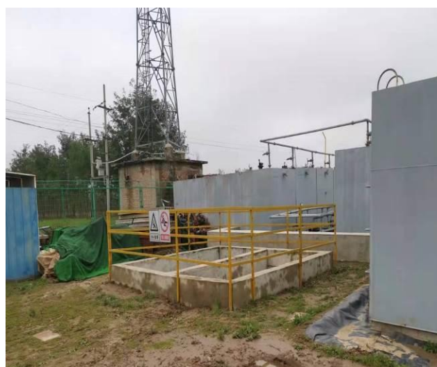
JH55 油井污水收集池
