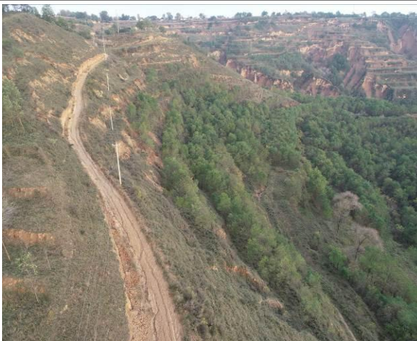
JH17P28 油井输变电线路
