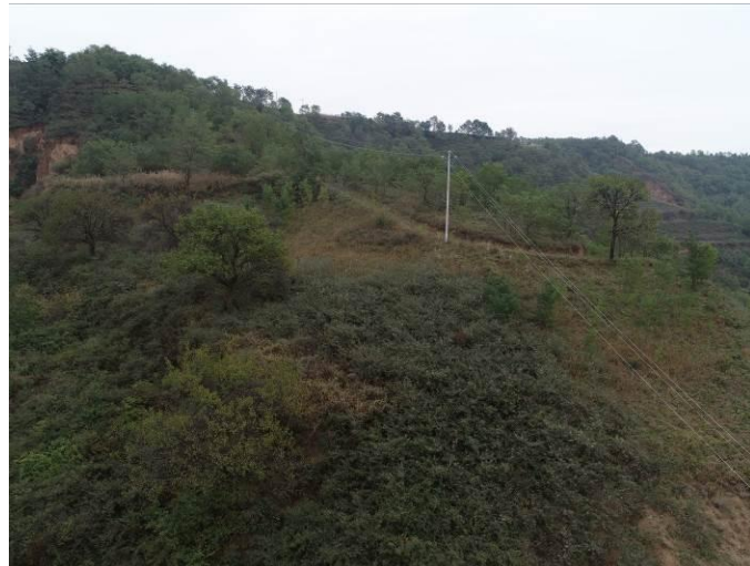
JH17P35 油井输变电线路
