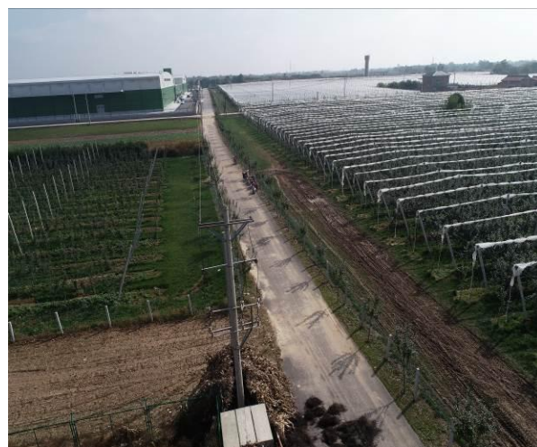
JH2P25 油井输变电线路
