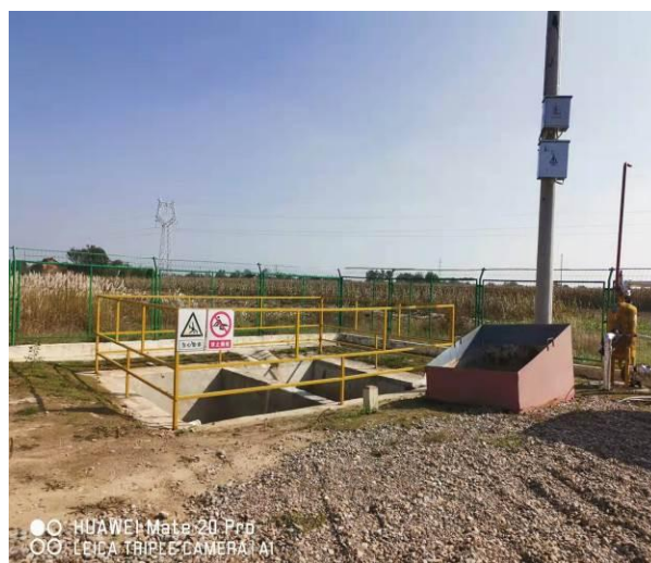
JH2P8 油井区污水收集池
