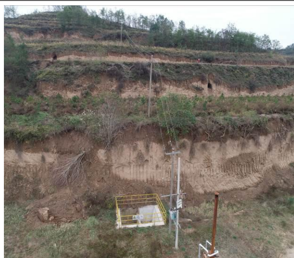
JH17P25 油井输变电线路
