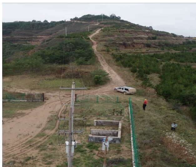
JH17P1 油井输变电线路
