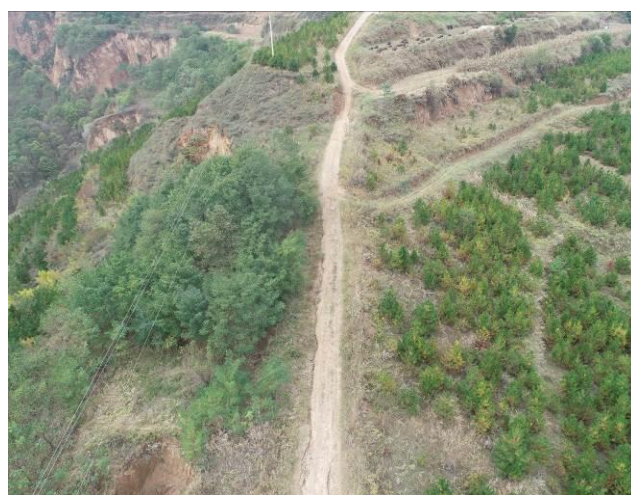
JH17P9 油井输变电线路
