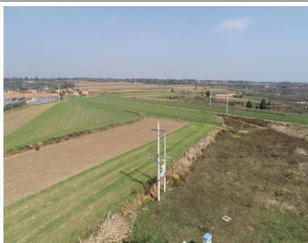
JH2P1 油井输变电线路
