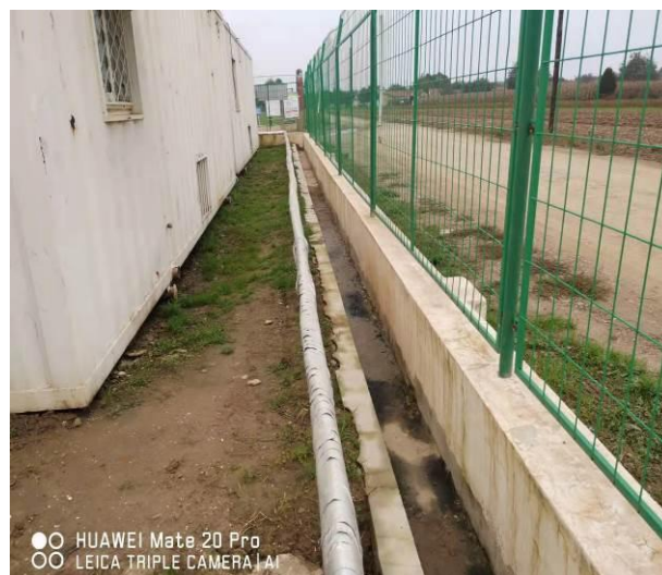
JH55 油井区排水沟
