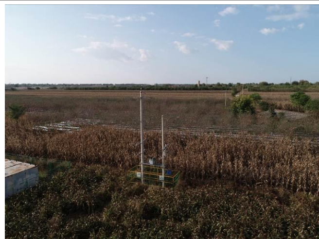
JH17P27 油井输变电线路
