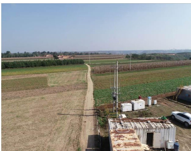
JH2P6 油井输变电线路
