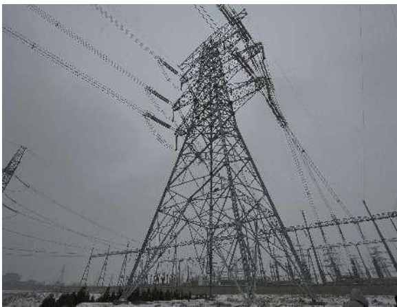
终点 55#塔基连接到 穆和 330KV 变电站
