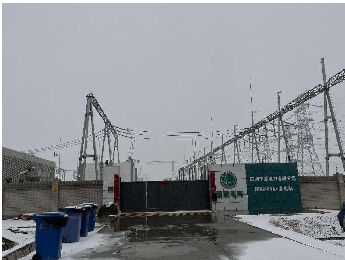
国网宁夏电力有限公司穆和 330KV 变电站（拍摄时间：2023年2月）
